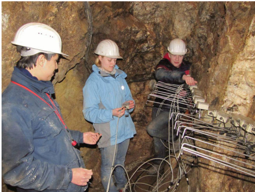
Installation der Elektrodenkette; Optimierung der Stromeinspeisung in die Stollenwand mit Hilfe eines Kontaktmittels; Jonathan, Sophie, Stefan (Moll)
